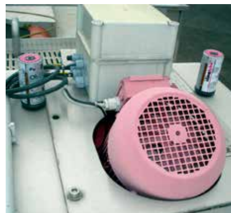
コンベアーチェーンへのシマルーベ125×2個によるオイル潤滑事例
